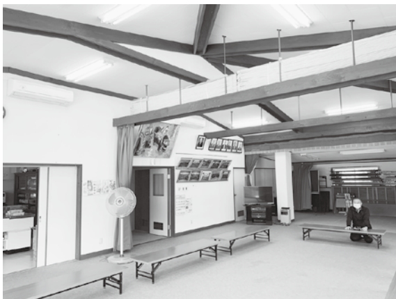
整備したエアコンのある広間
