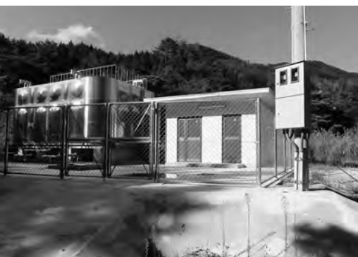
新しくなった日貫浄水場
