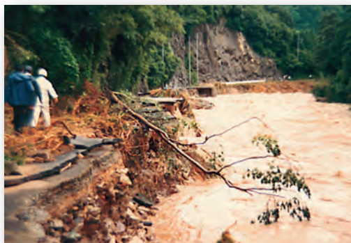
▲井原の断魚付近国道261号半分流失
