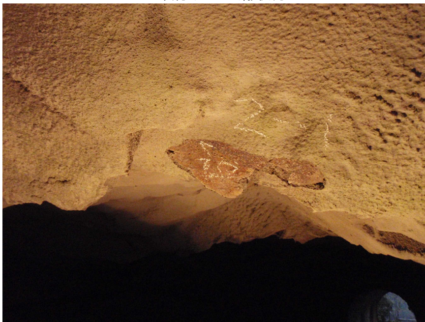
吹付けのはく離状況
