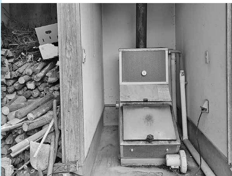
町内に設置された家庭用薪ボイラー
